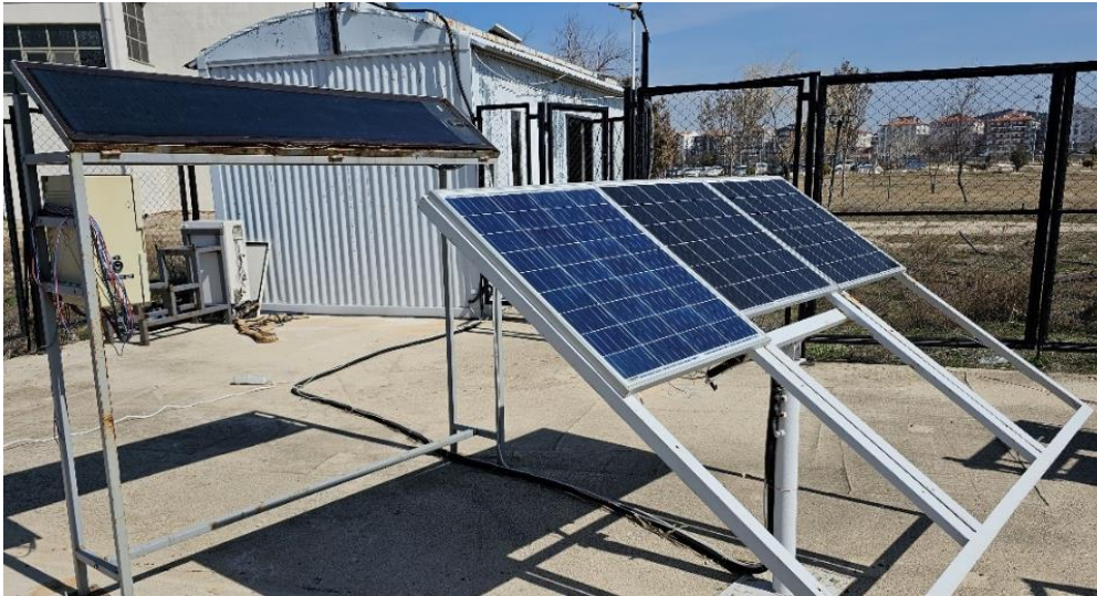
Resim 3.1 Kurulumu ait fotovoltaik panellerin görüntüsü
