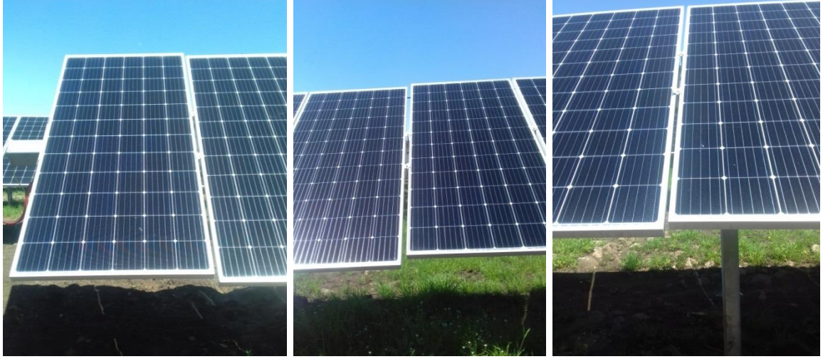
Şekil 5.21: GES-1 ve GES-2 Klempleri Kaymış FV Paneller
