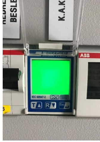
Şekil 5.32: Ges-3 Ekranı Çalışmayan Kaçak Akım Rölesi
