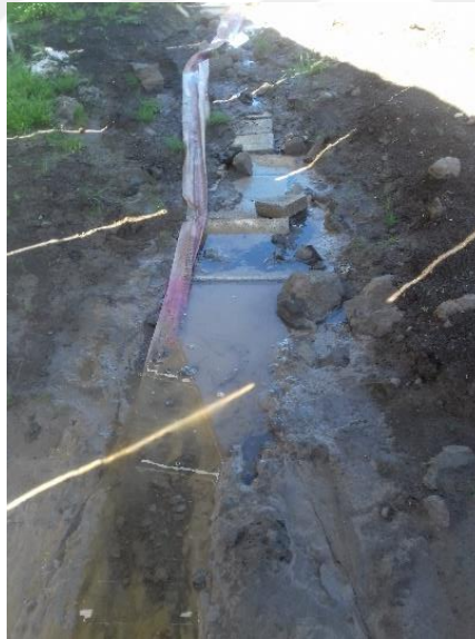
Şekil 5.5: Açıkta Bulunan Enerji Nakil Hatları
