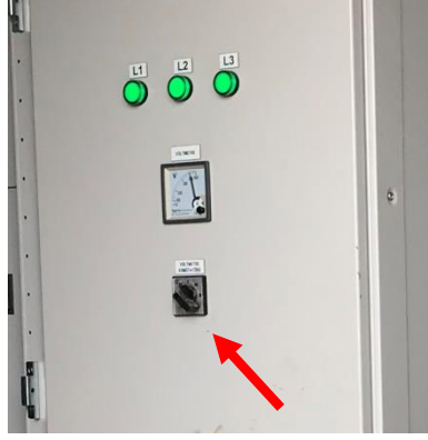
Şekil 5.36: Voltmetresi Çalışmayan AG Dağıtım Panosu
