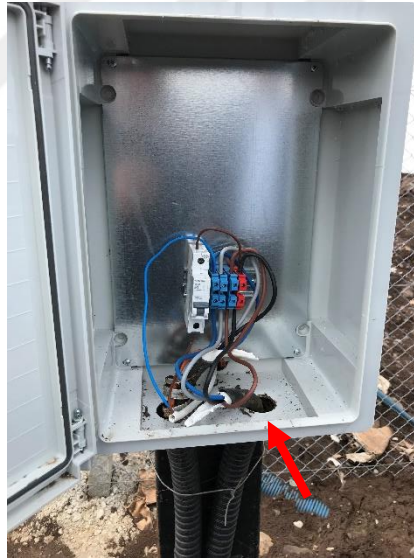
Şekil 5.24: Rakorları Takılmamış Aydınlatma Panoları
