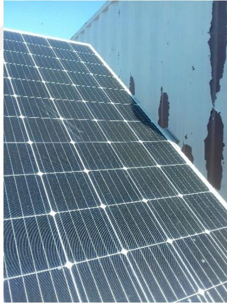
Şekil 5.22: Konteynerden Dolayı Gölgeleyen FV Panel
