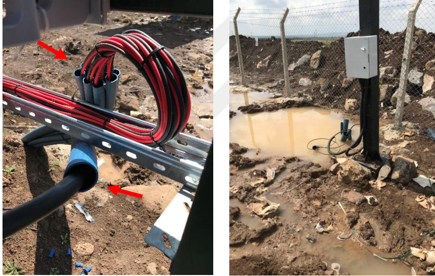
Şekil 5.3: Kablo Koruge Boruları ve Spiral Boruları Açık Kısımlar
