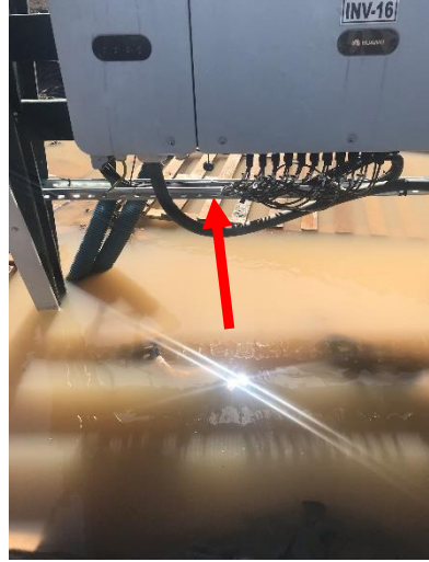
Şekil 5.23: Zemin Seviyesi Düşük Koruma Kapakları Açık İnverter
