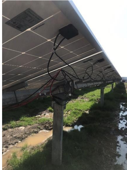
Şekil 5.10: DC Kablosu Sarkık Paneller
