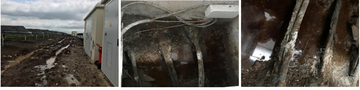
Şekil 5.2: Drenajı Yetersiz Yerler Trafo Köşkü
