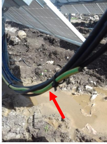
Şekil 5.19: GES-9 Topraklama Kablosu Takılmamış Kablo
