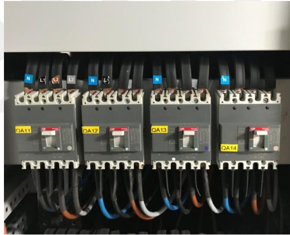
Şekil 5.33: AG Dağıtım Panosundaki Gevşek TMŞ' ler
