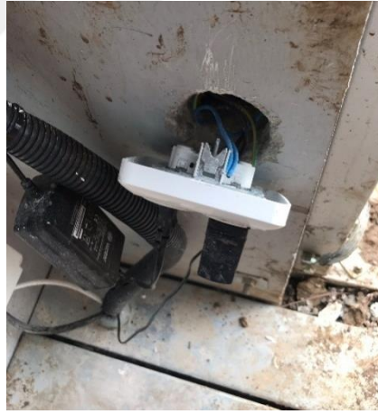
Şekil 5.35: İç İhtiyaç Prizi Problemlili Kısım
