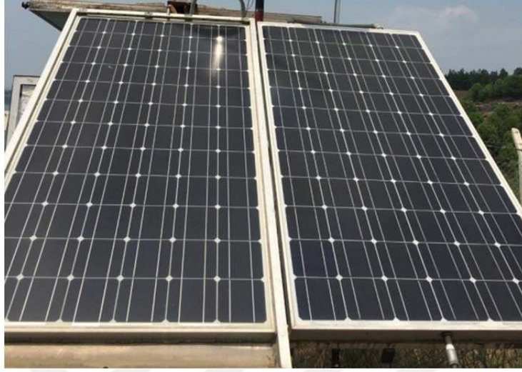
Şekil 3.16. Kurulumu tamamlanan hibrit enerji sistemi görüntüsü
