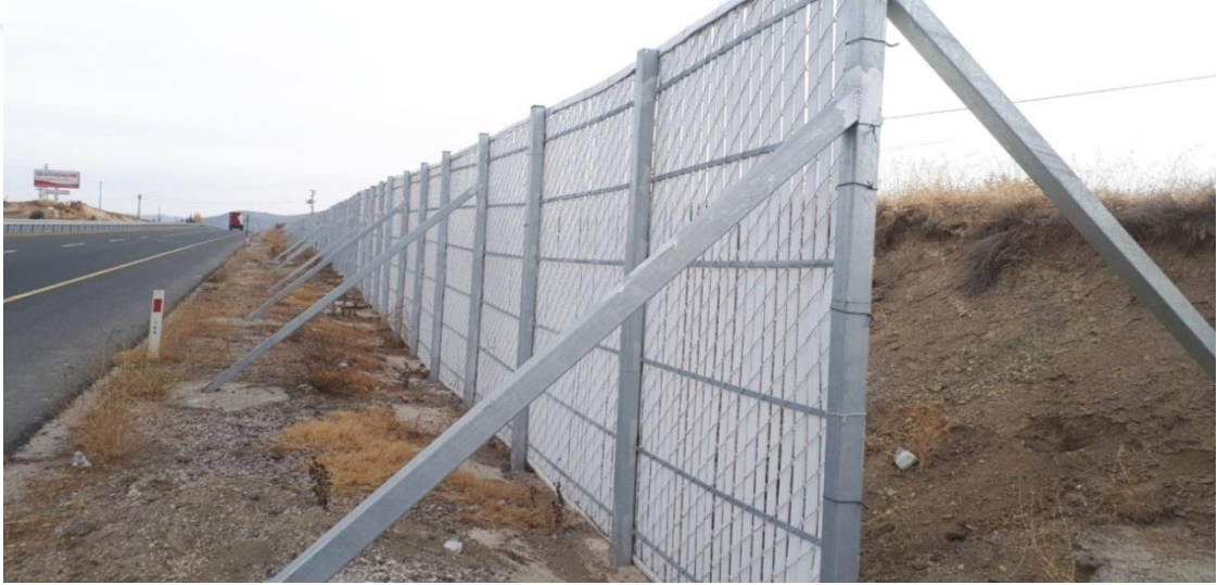
Şekil 3.40. Rüzgar ve rüzgar yükü ile taşınan tozun zarar vermemesi için yapılan öneri duvarı [44]
