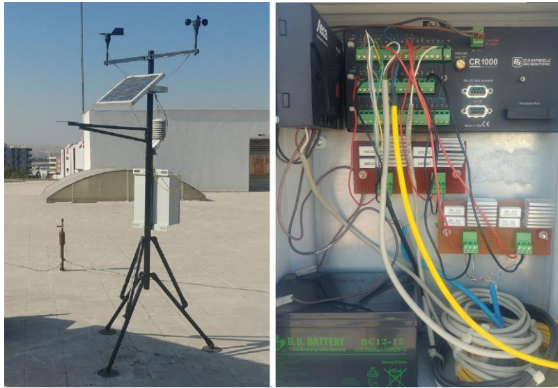
Şekil 6.8. Meteoroloji istasyonu ve data logger bağlantıları
