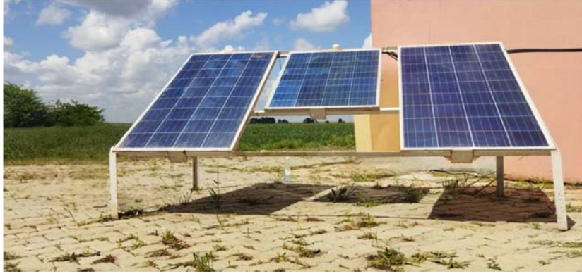
Resim 3.1. PV Güneş panellerinin montajlı görüntüsü
