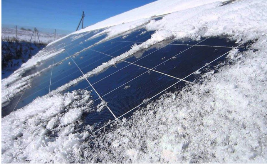
Şekil 4.2. Kar yağışı sonrası fotovoltaik paneller (URL-25, 2022)
