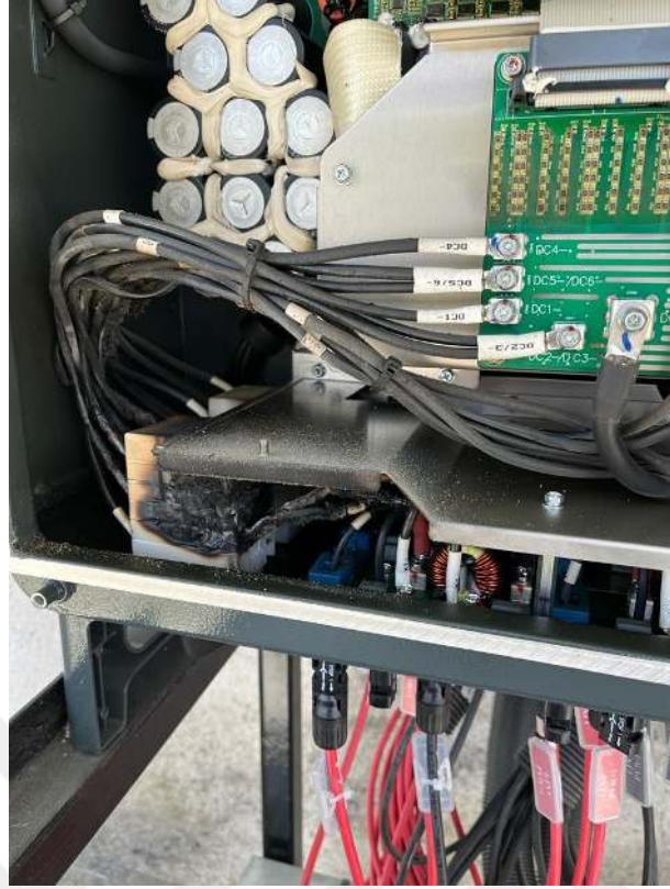
Şekil 4.21. İnverter kablo bağlantılarından kaynaklı yangınlar
