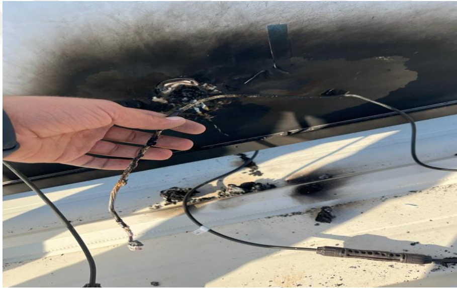
Şekil 4.25. Kısa devre sonucu yanmış kablolar
