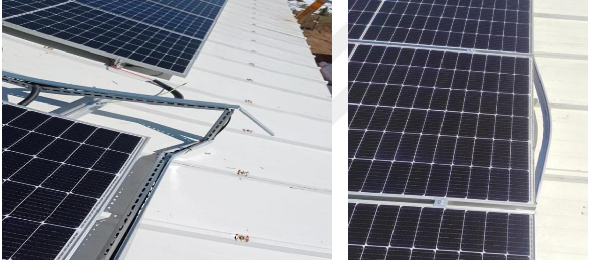
Şekil 4.3. Aşırı kar yağışı sonrasında zarar gören paneller
