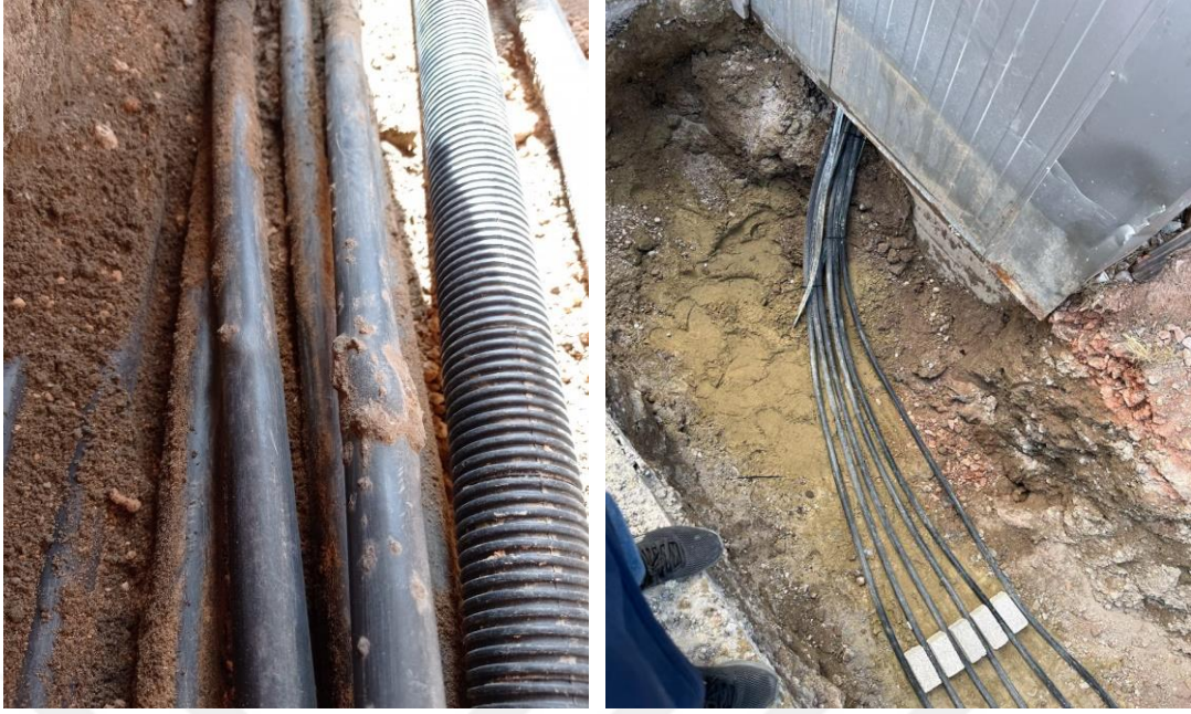
Şekil 4.14. Özensiz toprak altı kablo döşemesi
