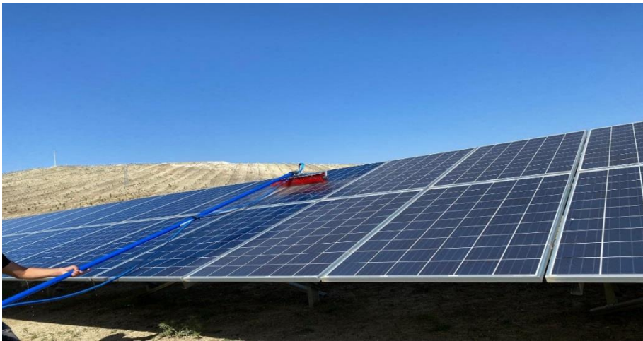
Şekil 4.6. Tozlanmanın manuel yıkama ile temizlenmesi
