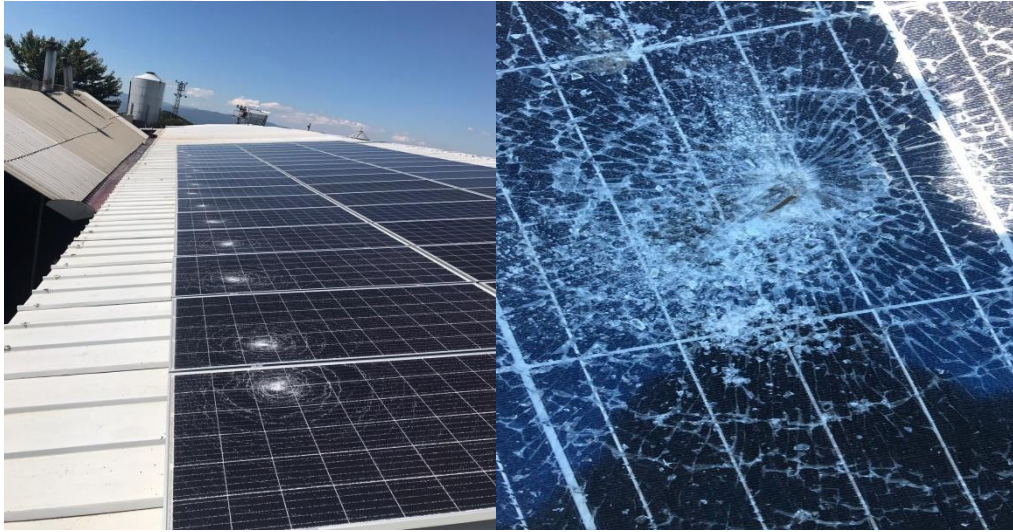
Şekil 4.17. Dış etkenlerden dolayı kırılmış paneller
