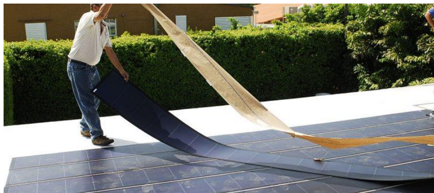
Şekil 3.6. Amorf silisyum fotovoltaik paneller [127]
