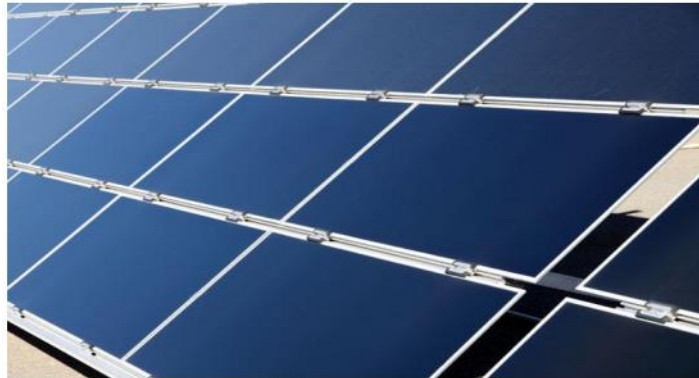
Şekil 3.7. Kadmiyum tellürid fotovoltaik panel [131]
