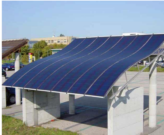
Şekil 1.11. Dış ortamda kurulumu gerçekleştirilmiş ince film güneş paneli (Uyar, 2016)
