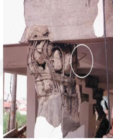
b) Uygun kanca yapılmamış
