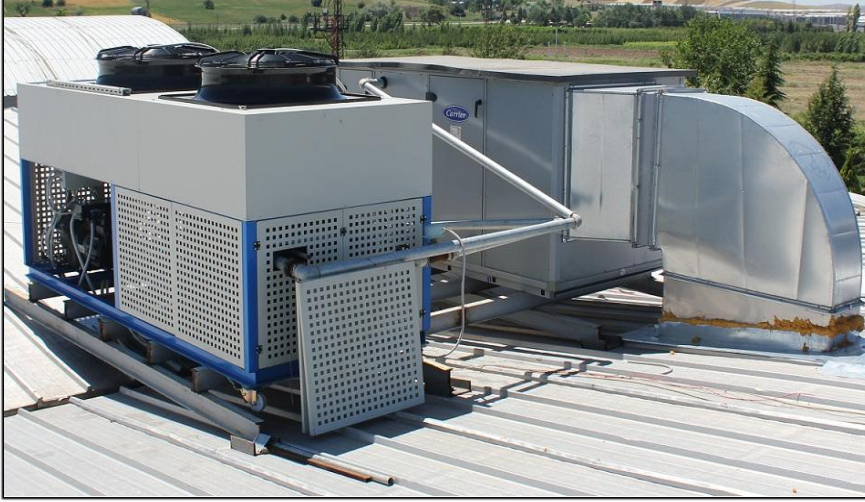
Şekil 3.26. Soğutma sistemi soğutma grubu
