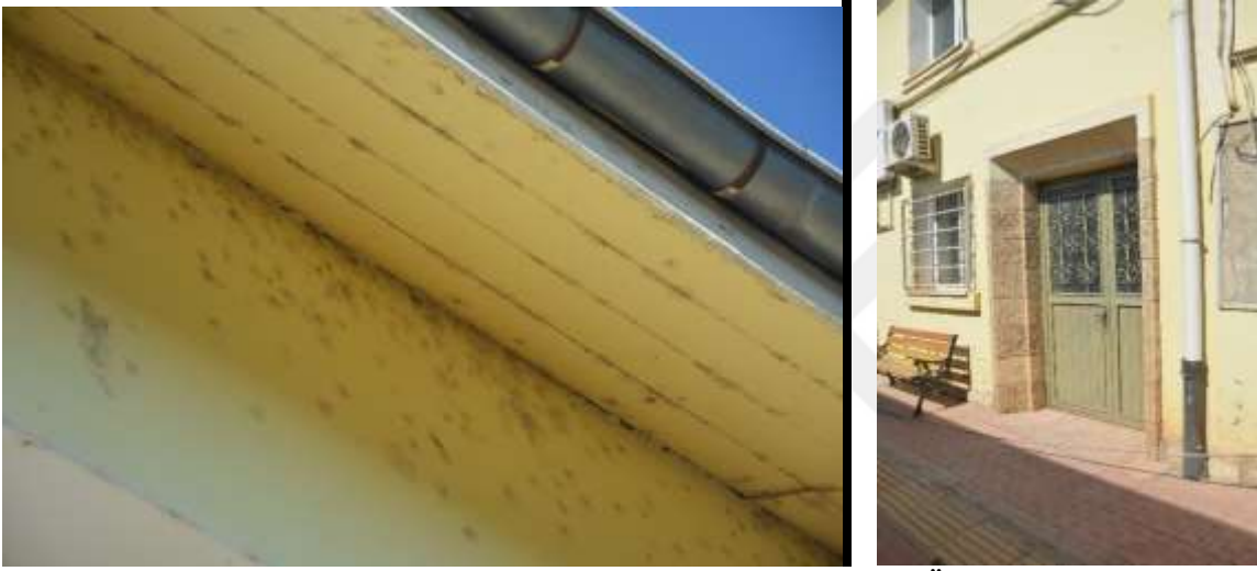
Şekil 4.96.-4.97. Hekimhan Gar Binası Sa ak Altı K flenmesi ve  zg n Olmayan Kapı (2020)
