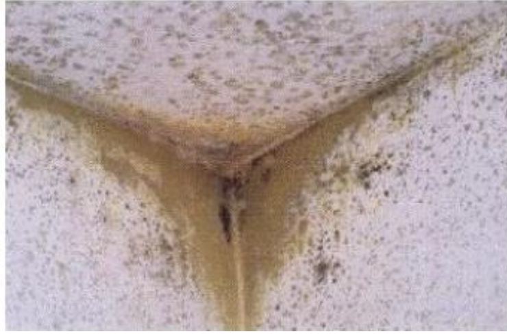
Şekil 5.16 Bina İçinde Meydana Gelen Yoğuşma
