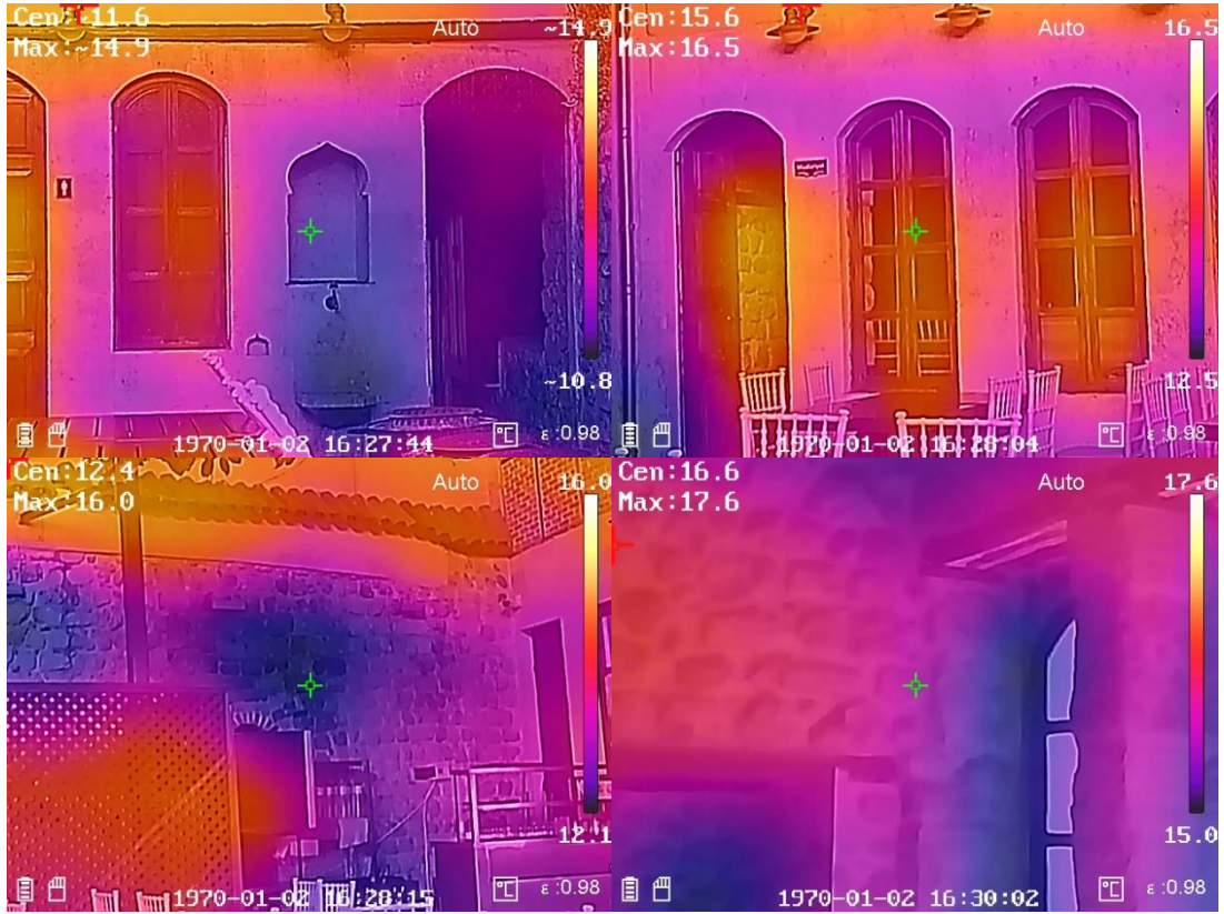
Şekil 6.85 328 parsel yapısına ait termal görüntü
