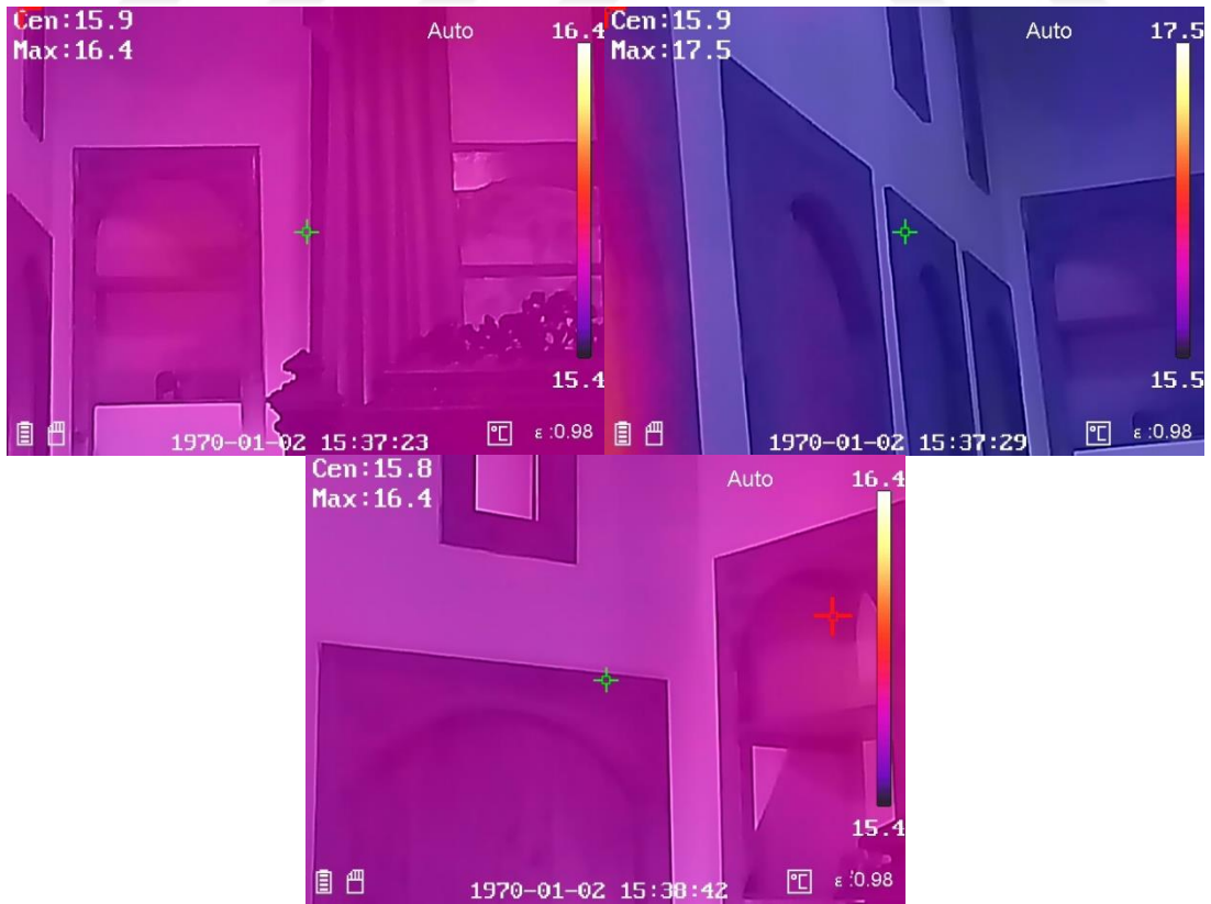
Şekil 6.74 591 parsel yapısına ait termal görüntü
