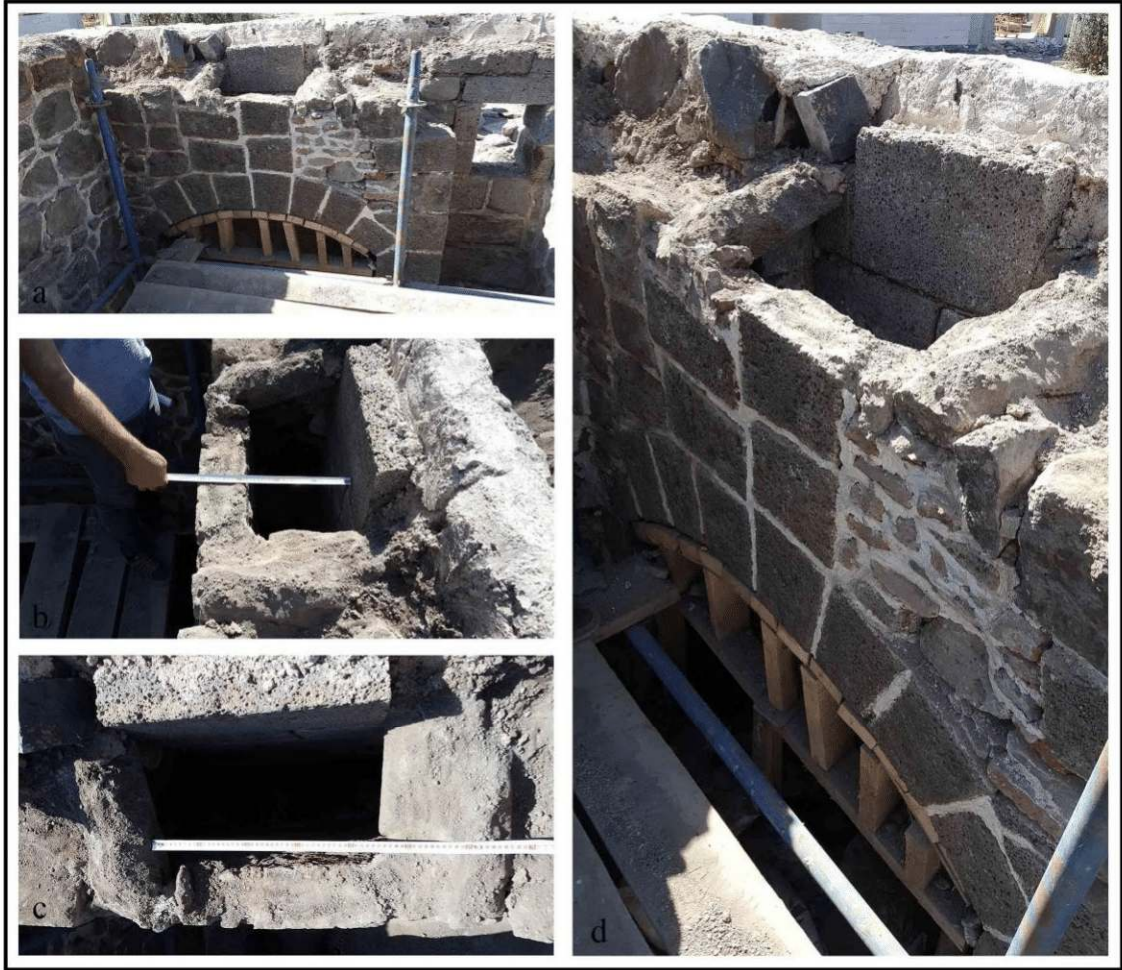
Şekil 4.183. Yıkılmış mutfak duvarı sonrası ortaya çıkan baca boşluğu
