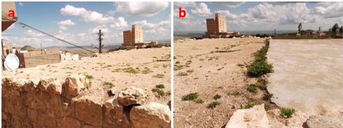
Şekil 6.8. Bir bölümüne beton şap dökülmüş bakımı yapılmamış toprak dam
