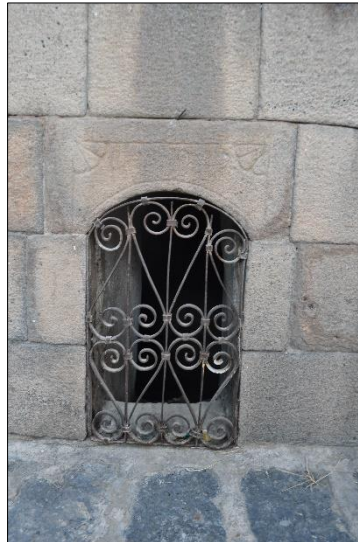
Şekil 4.94. Avlunun kuzeyindeki zerrembe (Hatipoğlu 2016)
