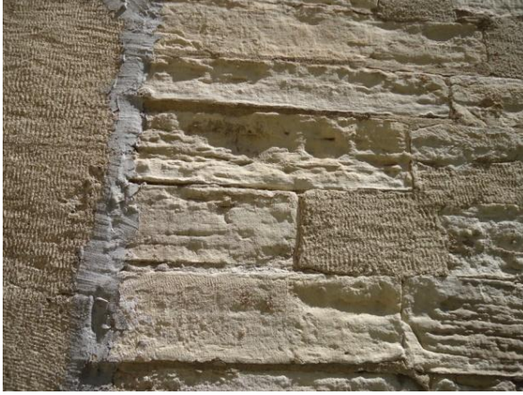
Resim 2.26. Çankırı Ulu Camii payanda yüzeylerinde ufalanma, 2011 [34]
