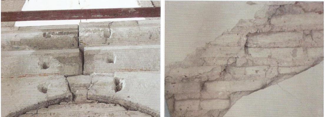
Resim 2.9. Edirnekapı Mihrimah Sultan Camii kemer ve duvarlarda çatlaklar, 2009 [33]
