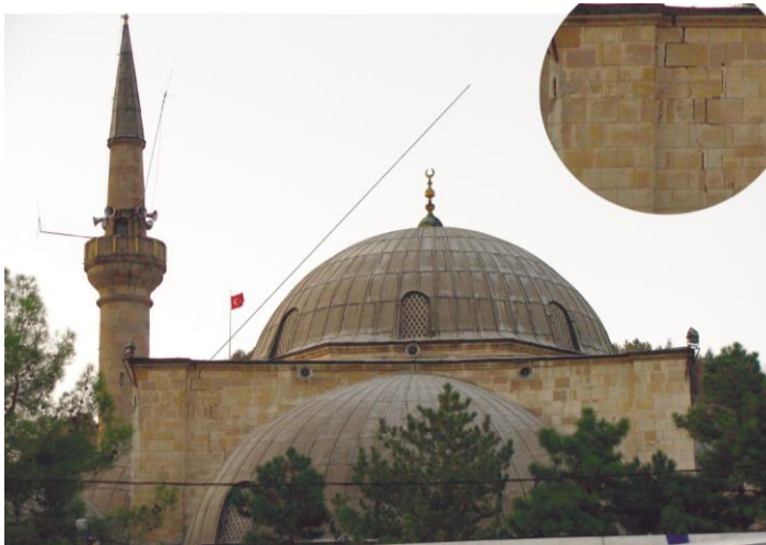
Resim 2.2. Çankırı Ulu Camii oturma çatlağı, 2008 [5]
