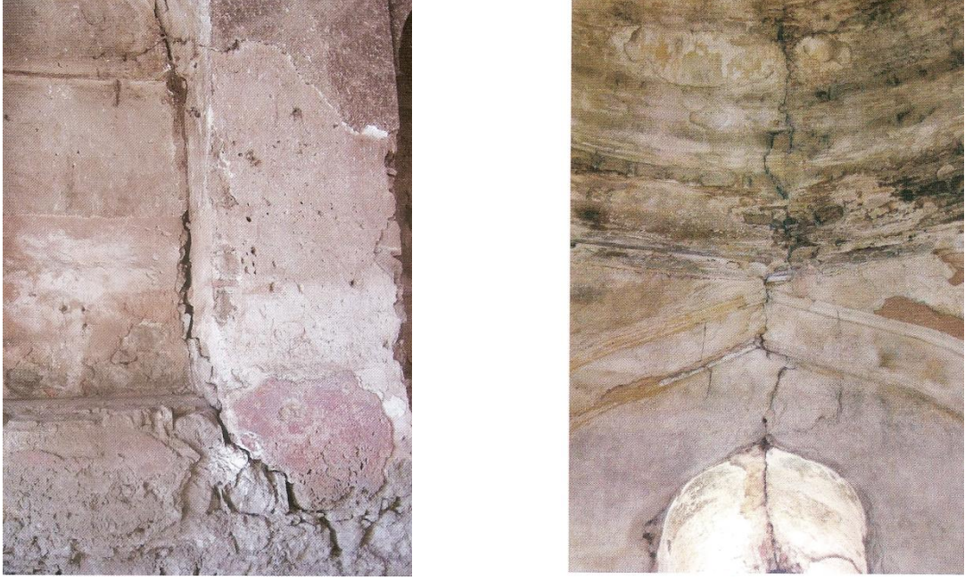
Resim 2.3. Oturmalarla bağılı oluşan çatlaklar [23]
