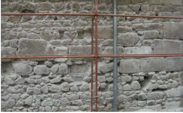
Resim 4.3.a. Ankara Altındağ Arslanhane Camii boşaltılmış derzleri, 2010 [5]
