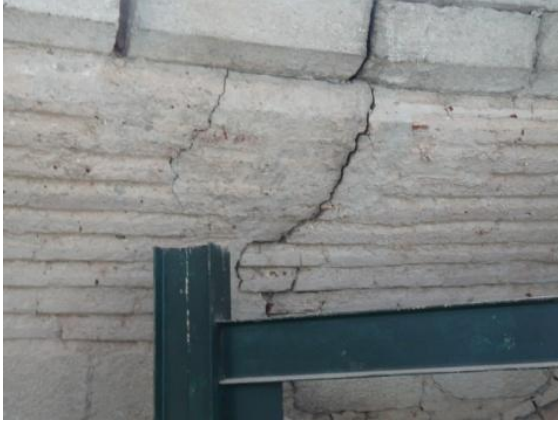
Resim 2.5. Edirnekapı Mihrimah Sultan Camii silmelerde diyagonal çatlak [33]
