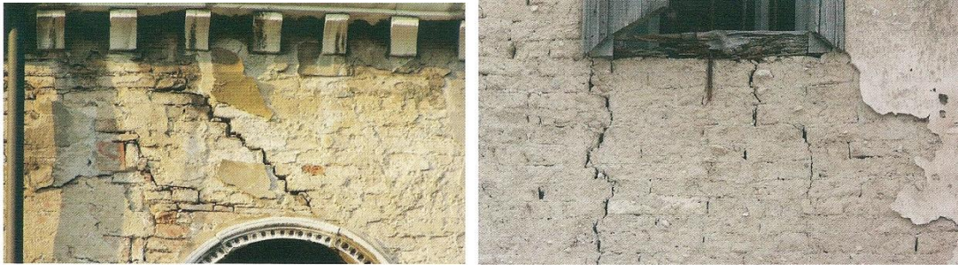
Resim 2.4. Duvar yüzeyinde düşey ve diyagonal çatlaklar [23]
