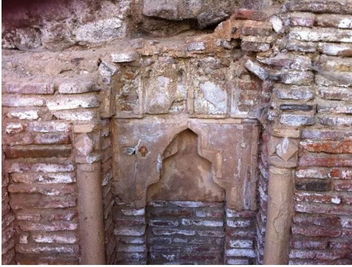
Resim 2.29. Ankara Sultan Alaaddin Camii avlusundaki namazgahtaki tuğlalarda oluşan tuzlanma, 2011 [34]
