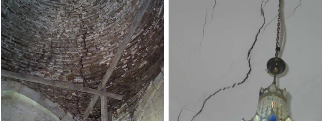
Resim 2.8. Adana Yeni Camii kubbede deprem çatlakları, sıva raspası sonrası yapılan sıvada aynı yerlerden çatlamış durumda, 2005, 2011 [1]
