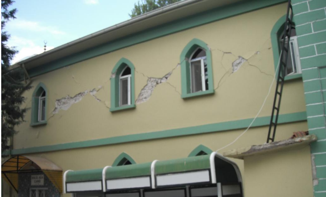
Resim 2.6. Simav depreminde Halil Ağa Camiinde oluşan deprem çatlakları, 2011 [58]
