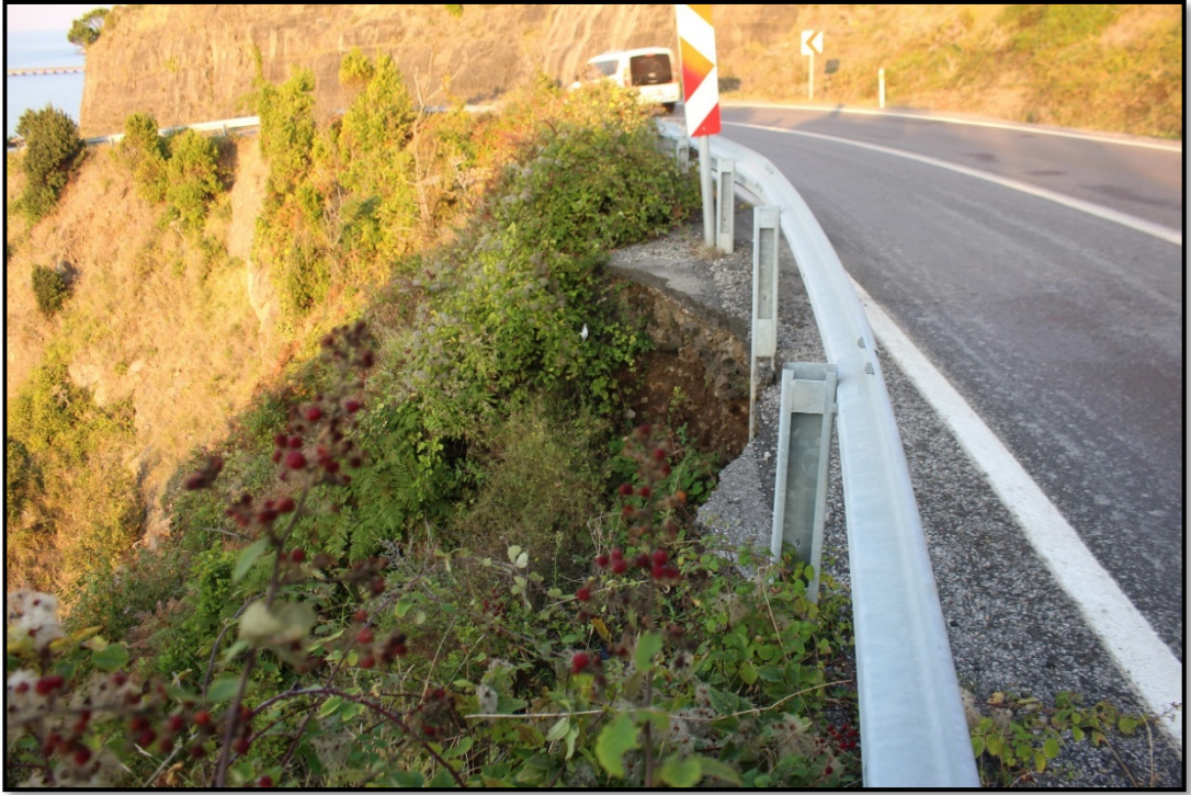
Foto 3.4: Türkali – Filyos arasında yamaç gerilemesi sonucu karayolunda meydana gelmiş ve gelmesi muhtemel bozulma.
