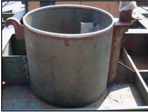
Şekil 6.58 Kargo tank giriş hatchi.
