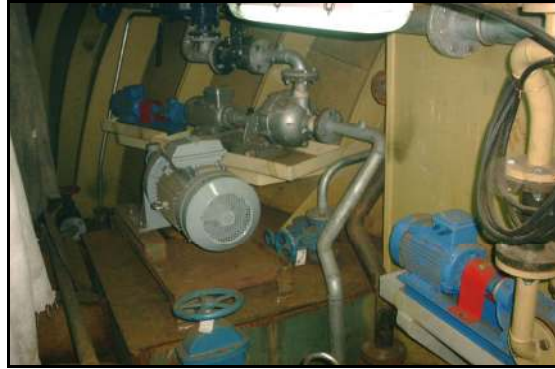
Şekil 4.11 Yakıt transfer pompaları.
