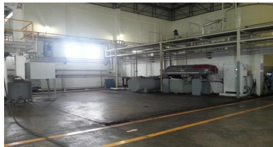
Şekil 4.8 : Proses sahası dekantör ünitesi.
