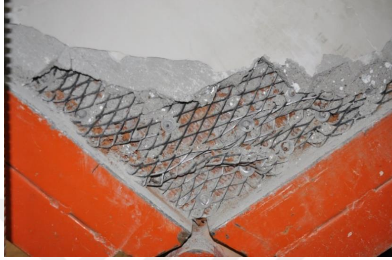
Şekil 5.2. MBW 3,0-200 deney elemanlarının deney sonu hasar durumu
