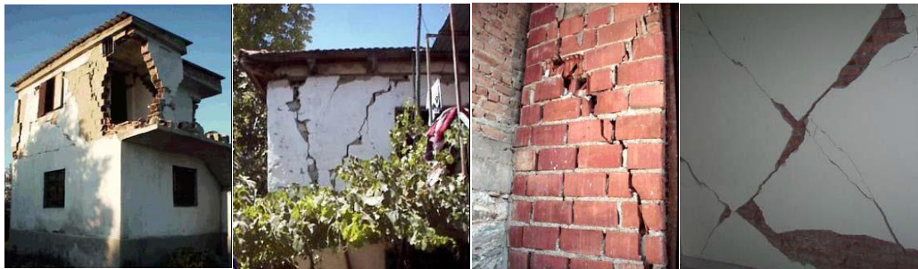
Şekil 3.3. Yığma yapıda oluşan duvar hasarları [26].
