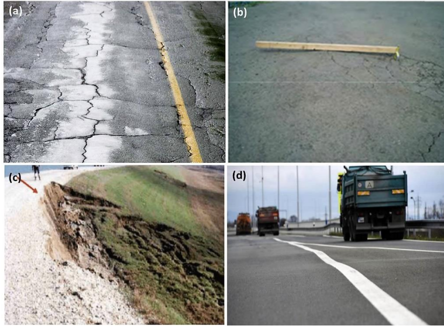
Şekil 1.3. Genleşen zemin kaynaklı tipik üstyapı hasarları (a) Blok çatlaklar, (b) Kaplamanın yükselmesi, (c) Şev kayması (d) Farklı seviyede oturmalar
