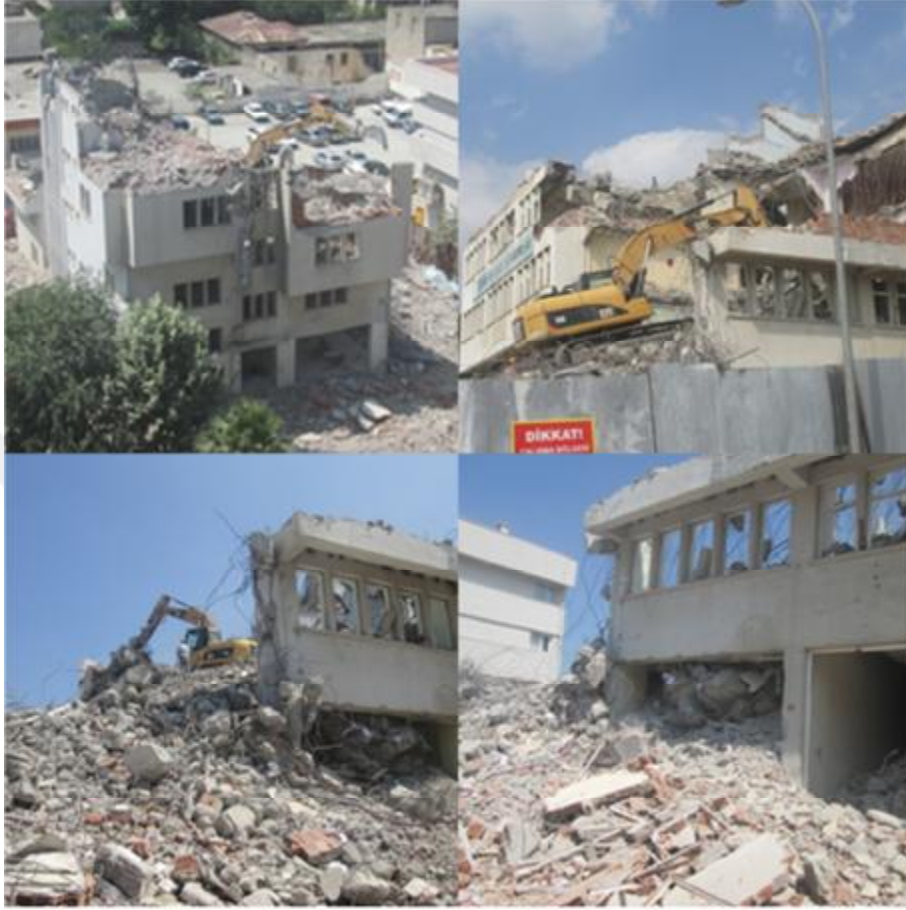
Şekil 3.7. Binanın Yıkılması (Ok ve Demir, 2018)
