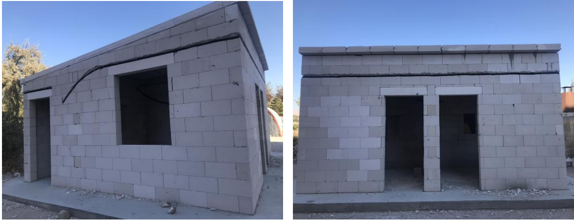
Şekil 3.7. Kaba inşaat aşamasından cephe tesisat görselleri
