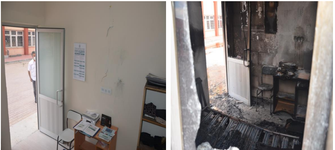
Şekil 3.23. Yatak odası kapı giriş bölümü yangın öncesi ve yangın sonrası görselleri
