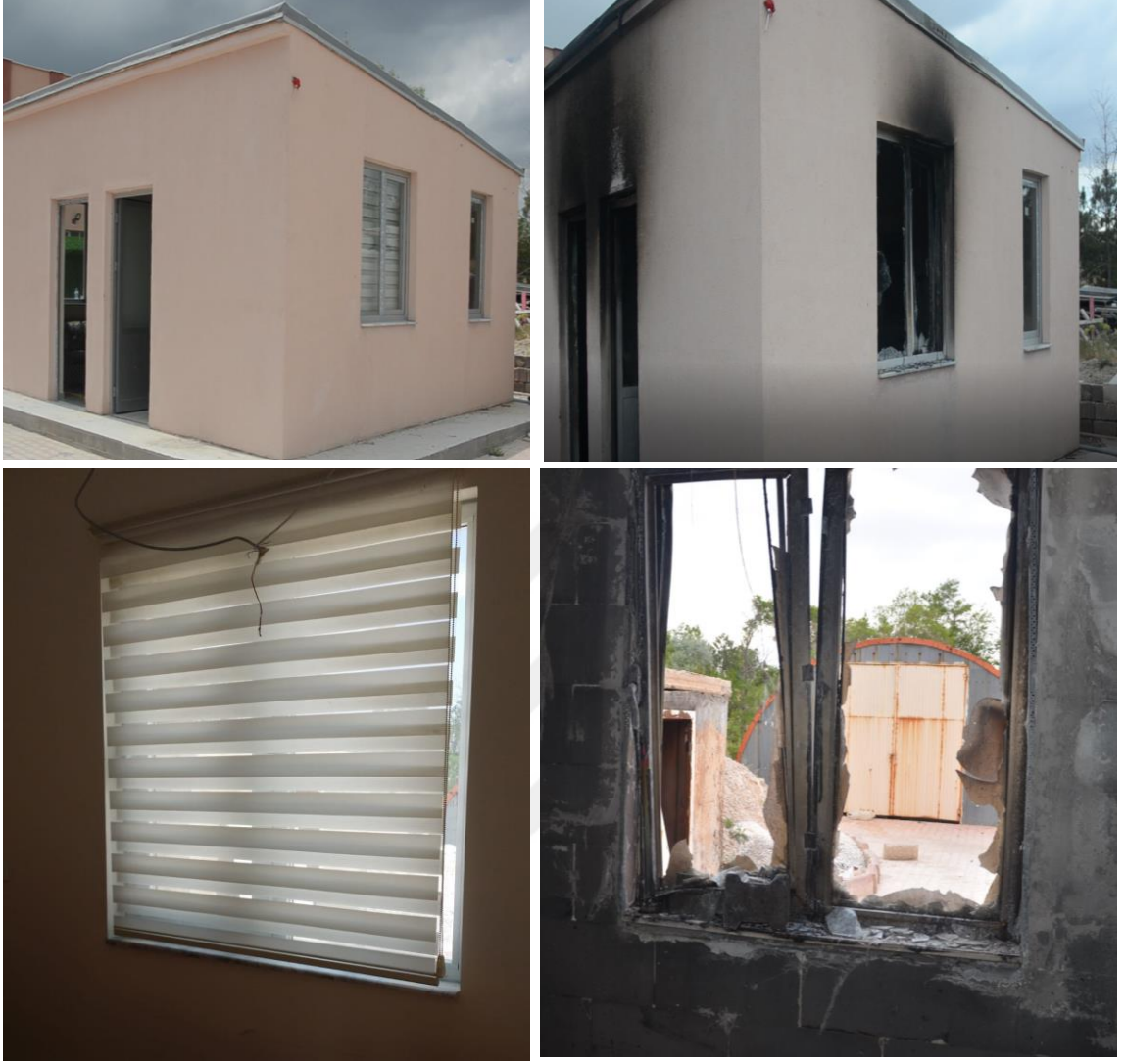
Şekil 3.25. Yatak odası alüminyum pencere yangın öncesi ve yangın sonrası içeriden ve dışarıdan görselleri
