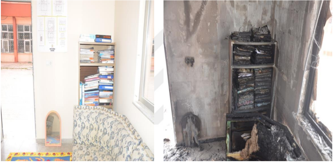
Şekil 3.30. Oturma odası giriş bölümü yangın öncesi ve yangın sonrası görselleri
