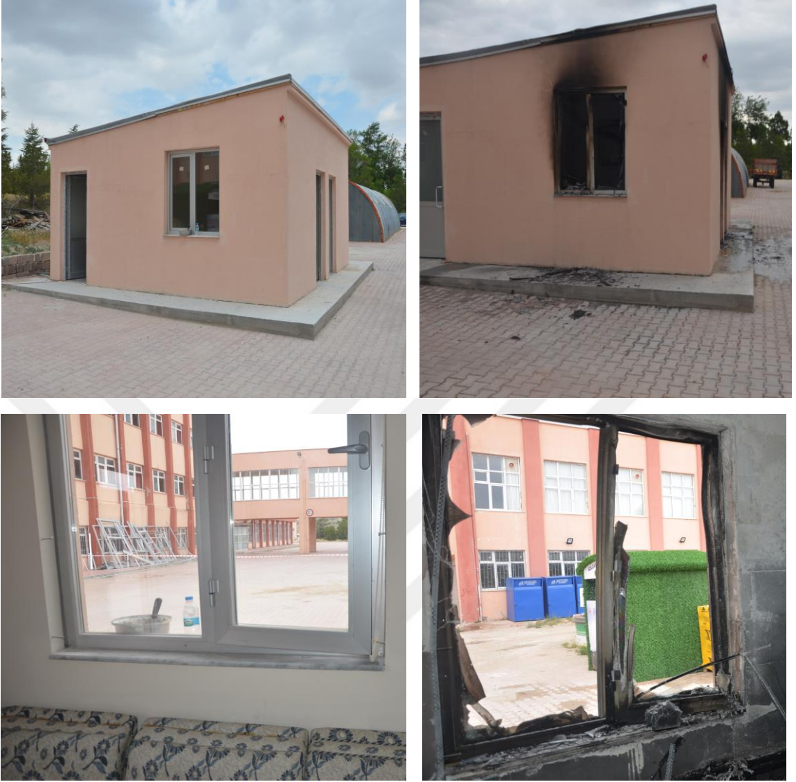
Şekil 3.31. Oturma odası alüminyum pencere yangın öncesi ve yangın sonrası içeriden ve dışarıdan görselleri
