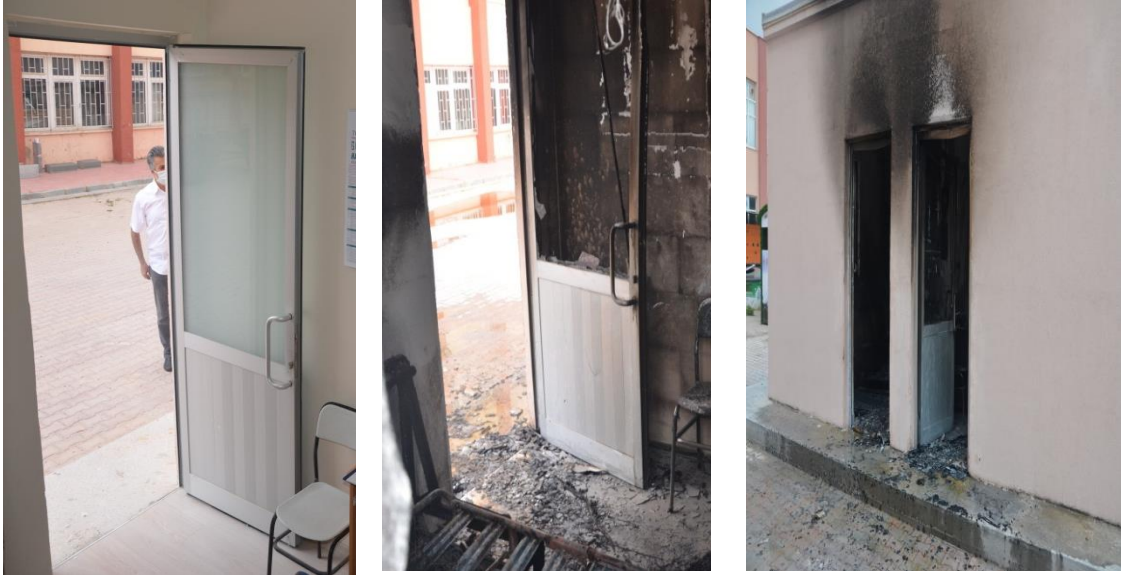
b. Yatak odası alüminyum giriş kapısı yangın öncesi ve yangın sonrası görselleri
