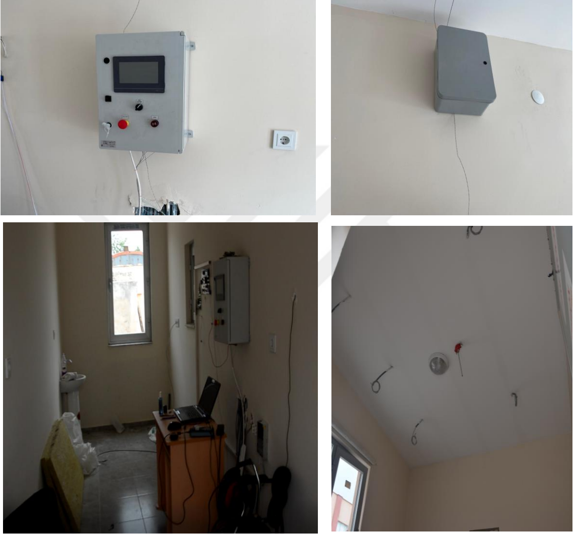
Şekil 3.11. Yangın öncesi kontrol panel odası ve oda içi sıcaklık termokupl görselleri ve özel geliştirilen anlık ölçüm kayıt paneli
