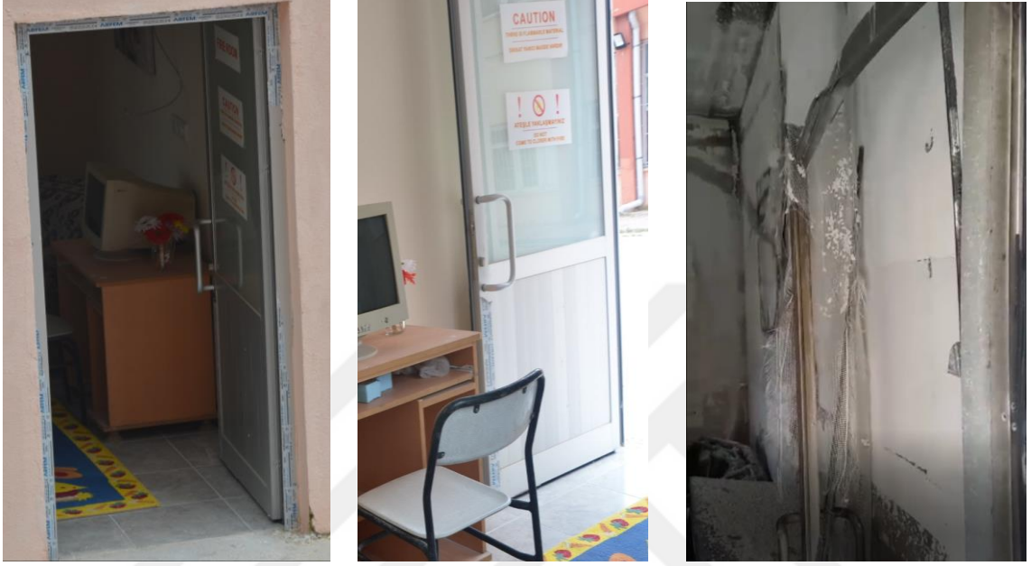
a. Oturma odası alüminyum giriş kapısı yangın öncesi ve yangın sonrası görselleri
