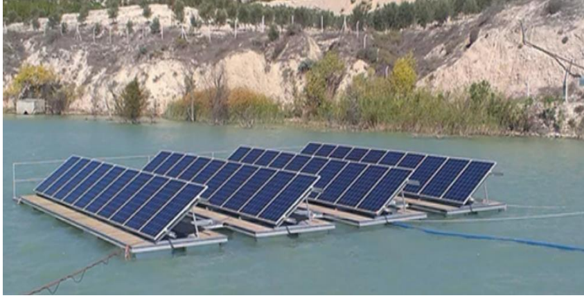
Şekil 1.27 Yüzer güneş santrali Azmak 2 Hidroelektrik Santrali [53]
