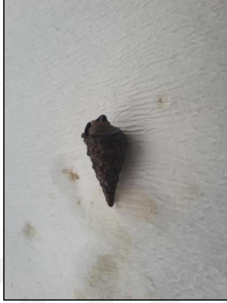
Şekil 4.14: Kolektörlere tutunan deniz minaresi.
