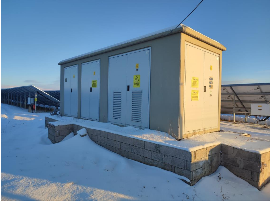
Şekil 2.7. Kabin tipi trafo köşk
