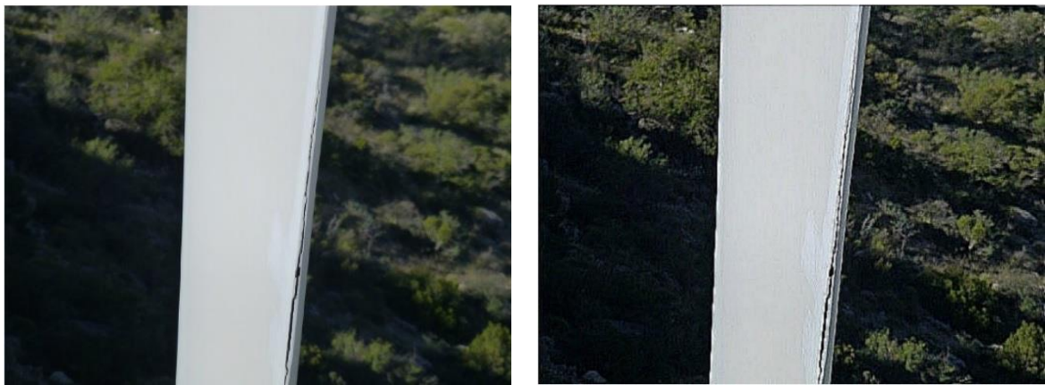
Şekil 3.4 Keskinleştirme filtresi uygulanmış arka kenar çatlaması [6].
