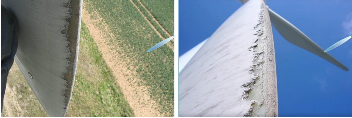
Şekil 2.2 Ön kenarda korozyon kirliliği.
