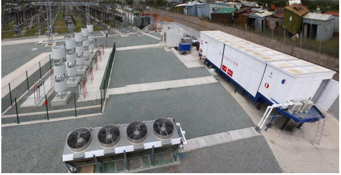
Şekil 4.19 Sincan trafo merkezi STATCOM uygulaması [53]
