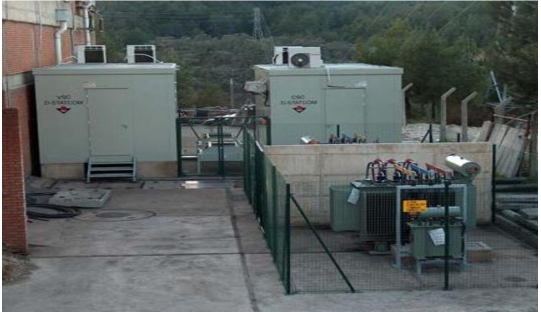
Şekil 4.20 Kemerköy termik santrali STATCOM uygulaması [54]
