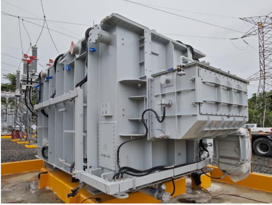
Şekil 2.5. Saha Montajı Öncesi Transformatör Tankı
