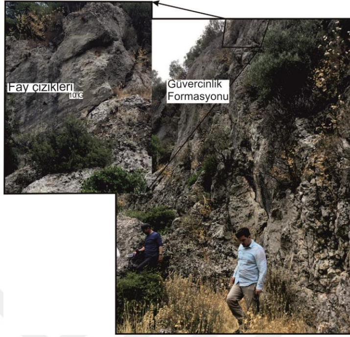
Şekil 4.5 Kapıkaya Deresinin güneyinde yer alan Güvercinlik Formasyonuna ait Kireçtaşlarında gözlenen sağ yanal atımlı (düşük rake açısı) doğrultu atımlı faya ait fay çizikleri (insan boyu 170 cm) (Koordinat: 468376/4238491) (Kişisel arşiv, 2019)
