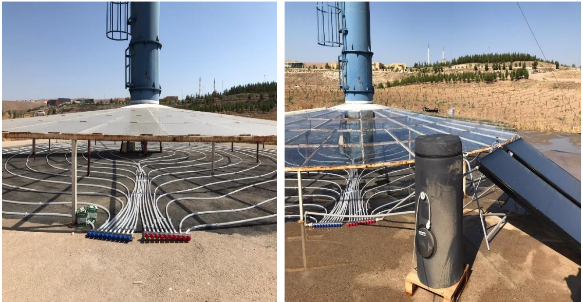
Şekil 3.5. Güneş enerjili sıcak su sistemi döşenmiş kolektör alanı
