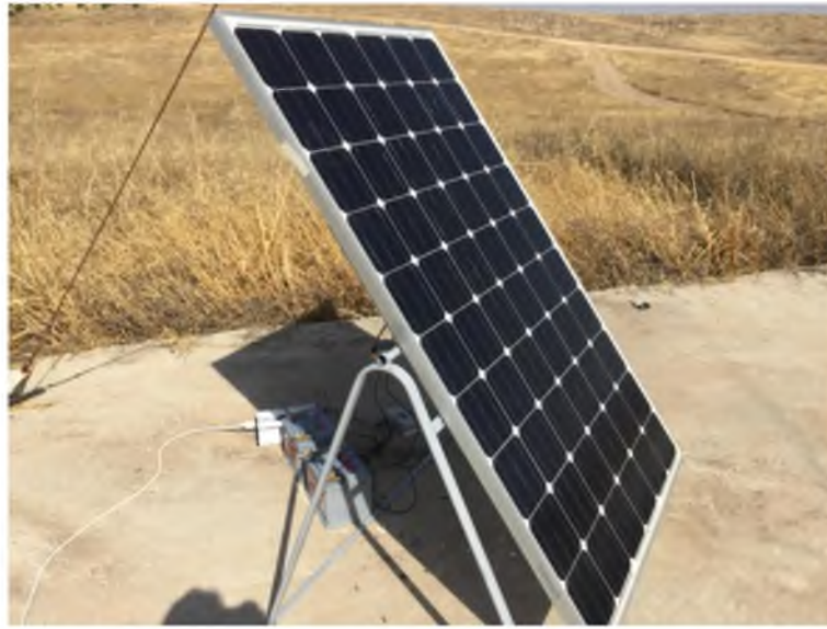
Şekil 3.13. Elektrik ihtiyacı için kullanılan Fotovoltaik (PV) Sistem
