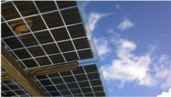
Şekil 3.10. Çift yüzlü güneş paneli örneği (Altaai, 2023)
