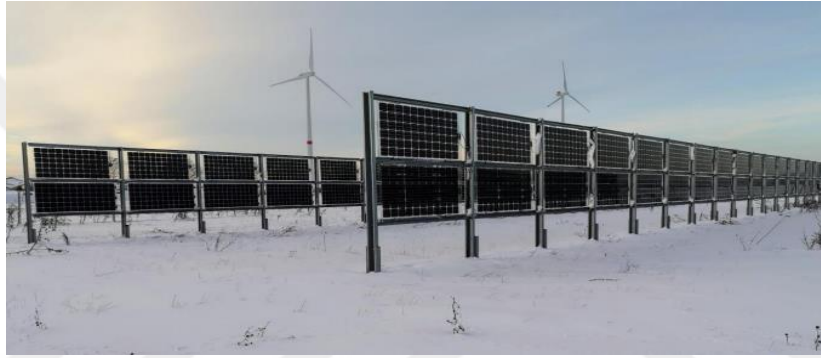
Resim 8. 9. Dikey çift yüzeyli panellerle yapılmış fotovoltaiik sistem (Erken, 2022)
