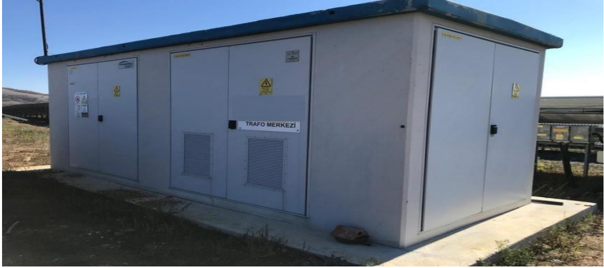
Resim 4. 1. Trafo kabini ve trafo (Naziksoy, 2022)
