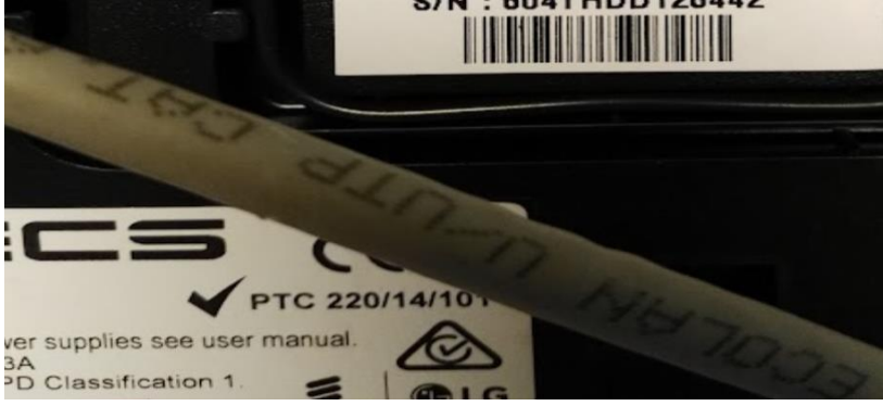
Resim 4. 7. Veri iletim kablosu
