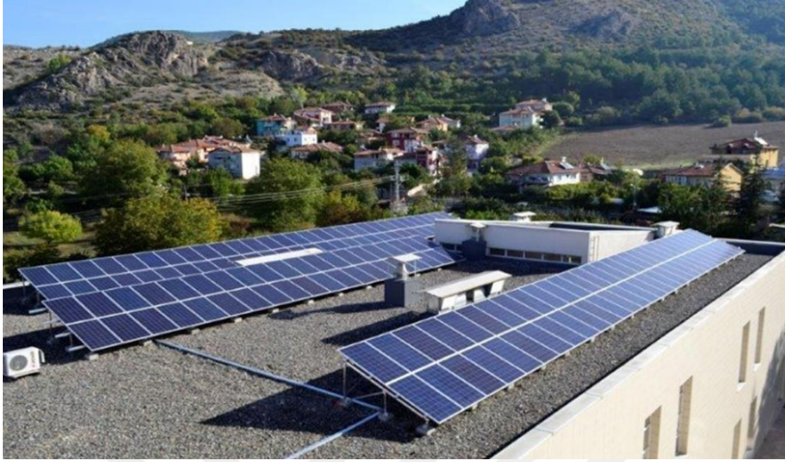
Şekil 3.2. İpekköy güneş enerji santrali (Tokul, 2021)
