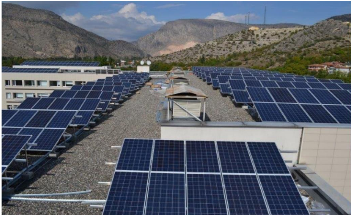
Şekil 3.1. İpekköy güneş enerji santrali (Tokul, 2021)
