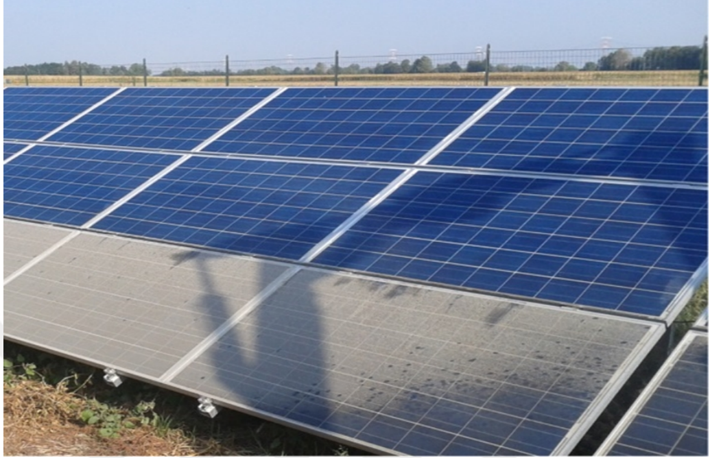
Şekil 3.18. Temizlenmiş ve tozlu panellerin görüntüsü
