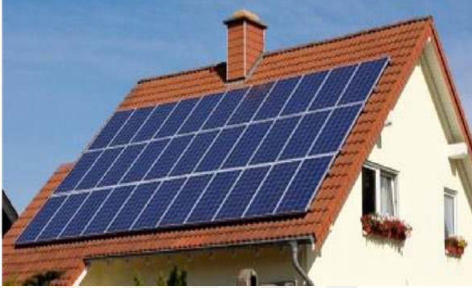
Şekil 3.10. Eğimli Bir Çatıya Kurulmuş Güneş Panel Sistemi
