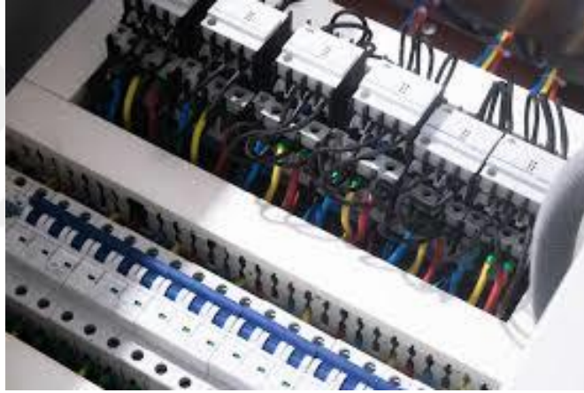
Şekil 1.12. Kaçak akım rölesi.
