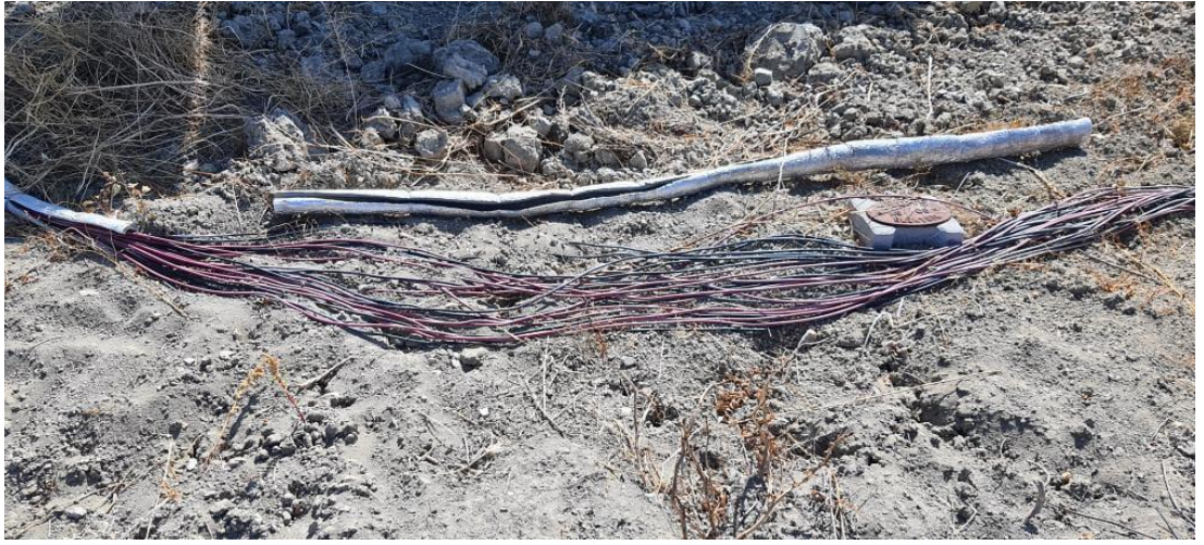
Resim 2.7. Güneş enerji santralinde dağınık ve düzensiz kablolar.
