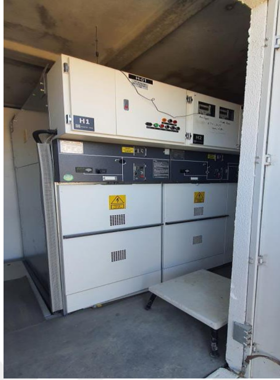
Resim 2.4. Güneş enerji santralinde trafo odası(kesici ölçü kabini) [1].
