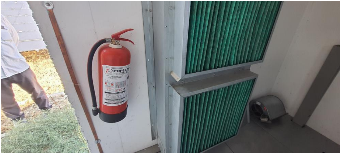
Resim 2.11. Hazırda bulunan bir yangın tüpü.
