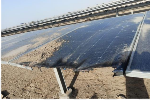
Resim 2.15. Zarar görmüş bir panel.
