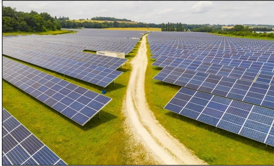
Şekil 4.5 Fotovoltaik güneş enerji santrali
