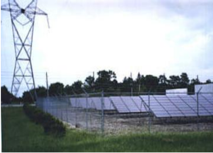
Resim 2.11. Şebekeye elektrik veren güneş pili (PV) sistemi
