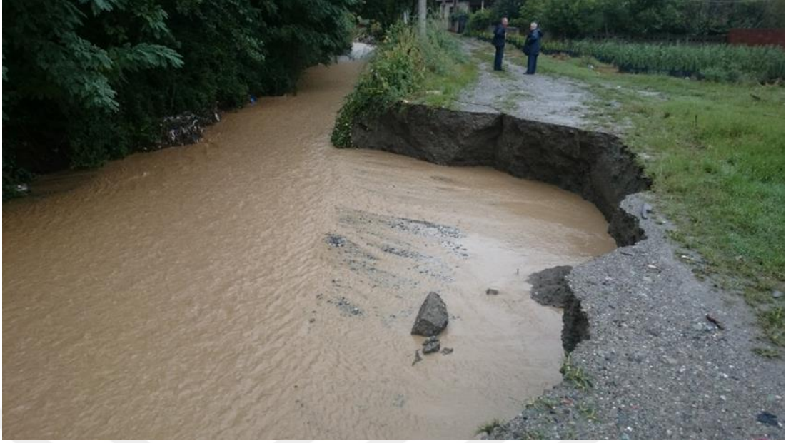
Şekil 5.11. Sapanca Keçi Deresinde hasar gören yol durumu
