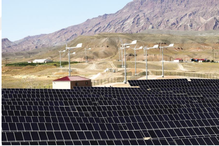
Şekil 16. Rüzgar-Güneş Hibrit Elektrik Kaynağı, Nahçıvan
