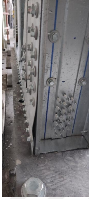
Şekil 5.57. W3 deney elemanı guse plakalarında oluşan deformasyon.
