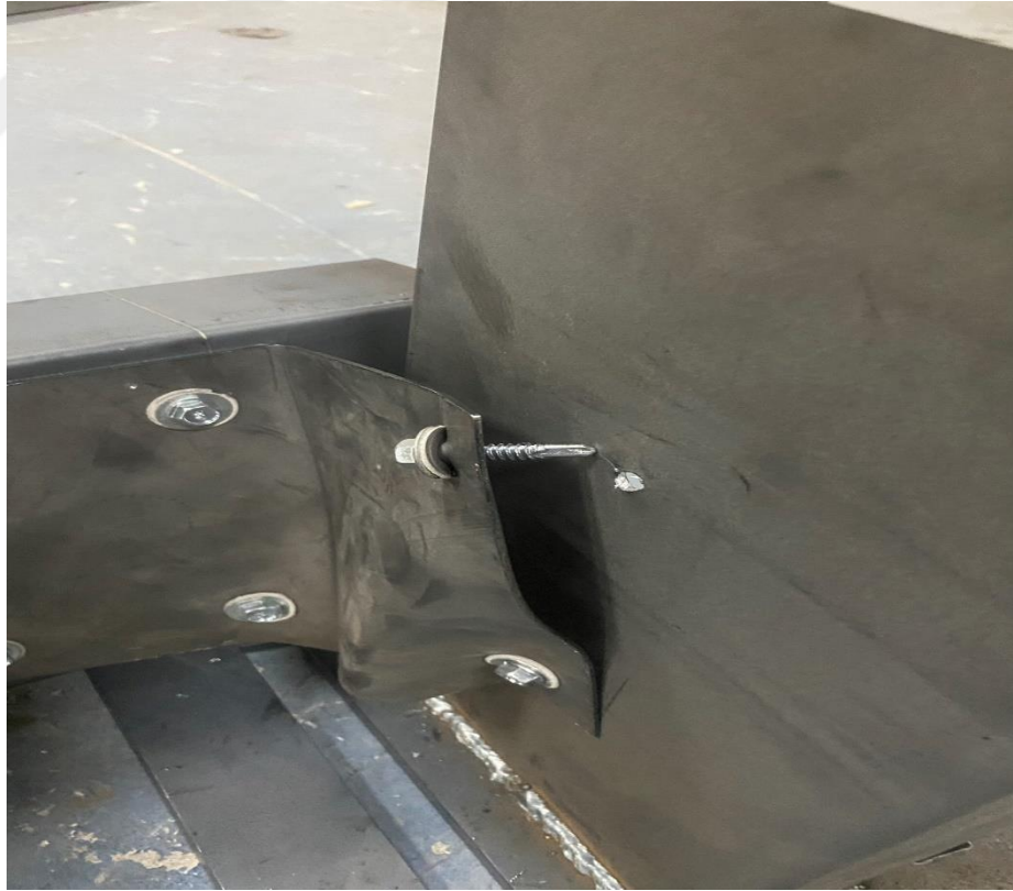
Şekil 4.73. Kolon tarafında köşebent akıllı vida sıyrılması durumu
