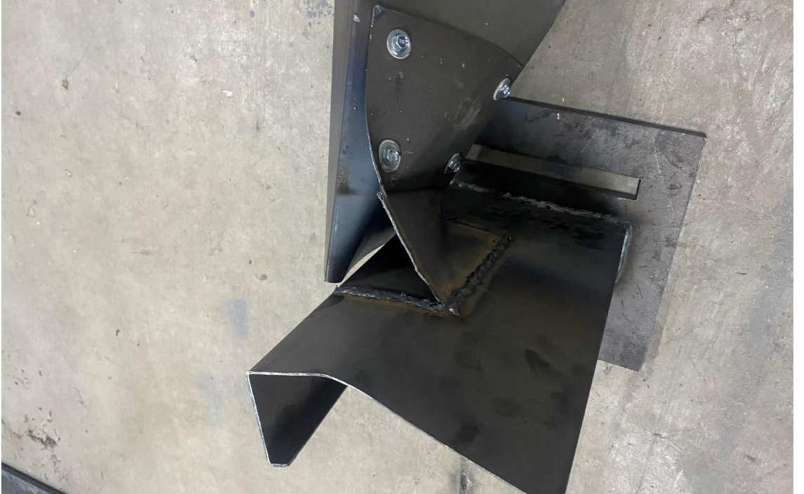
Şekil 4.75. Kaynaklı birleşim kolon burulmalı burkulması, köşebent kaynak yırtılması ve kiriş burkulması durumu (Yavuz 2023).
