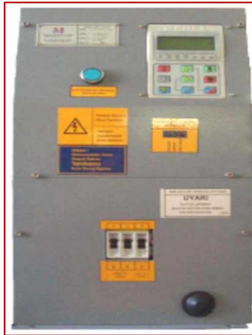
Şekil 2.5 İnverter ünitesinin genel görünüşü.
