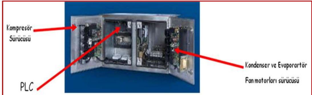
Şekil 2.3 Statik konvertör ünitesinin genel görünüşü.
