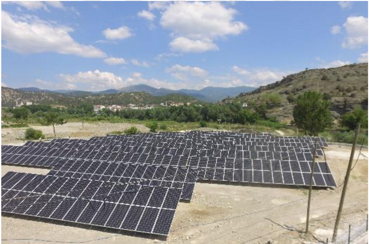
Şekil 4.2 Hanönü (Kastamonu) Güneş Enerji Santrali Kurulu Hali
