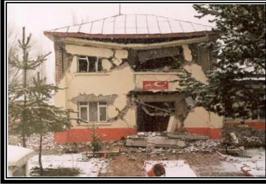
Erzurum depreminde (2004) hasar gören Aşkale ilçesi Askeri Garnizon binası [37]
