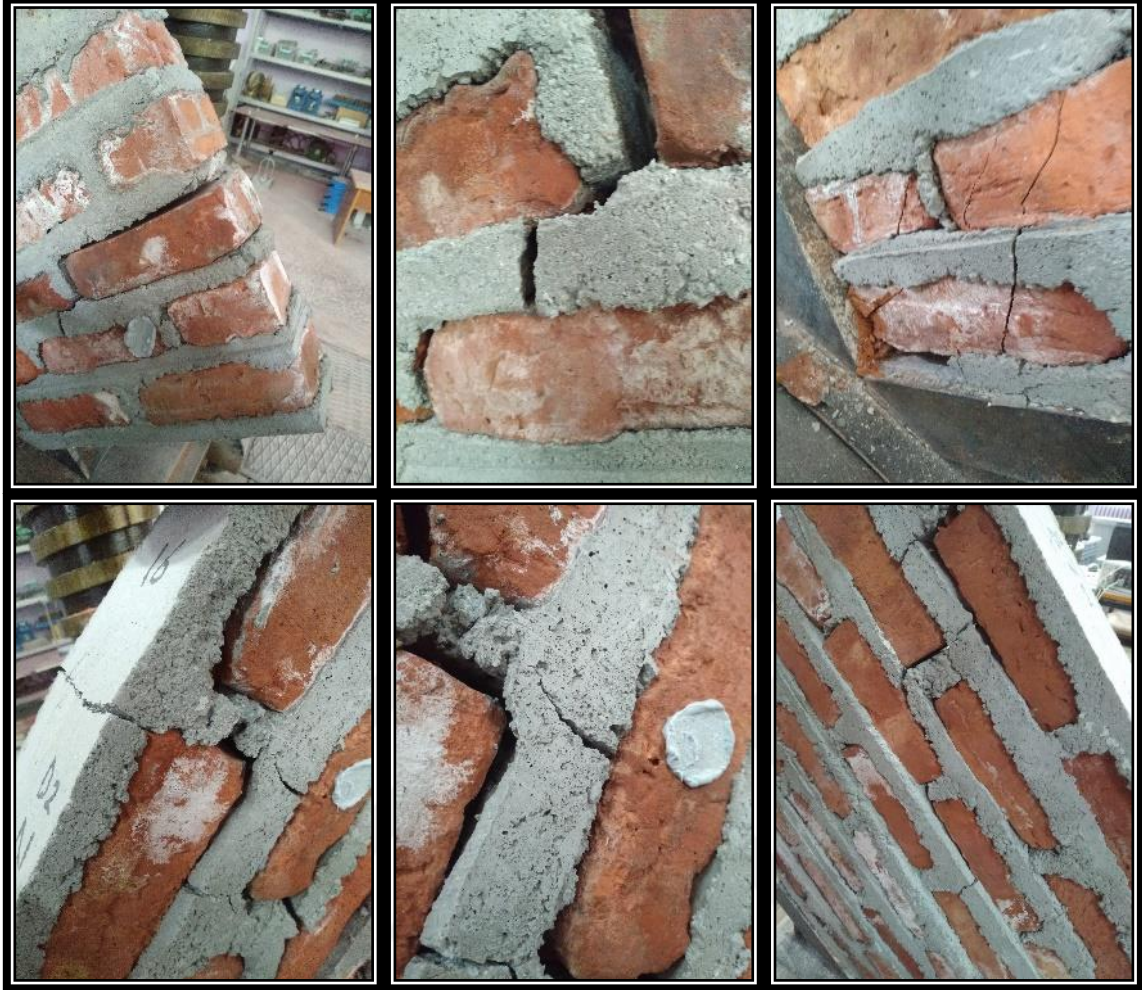
Şekil E1.23. D2NHO2 tip duvarlara ait hasar fotoğrafları
