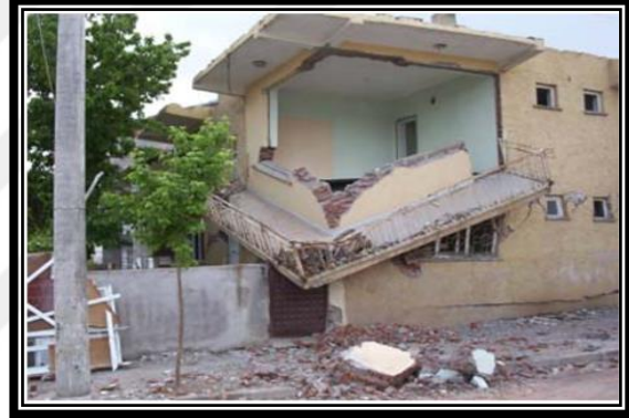
Bingöl depreminde (2003) hasar gören konsol çıkmalı yığma yapı [39]
