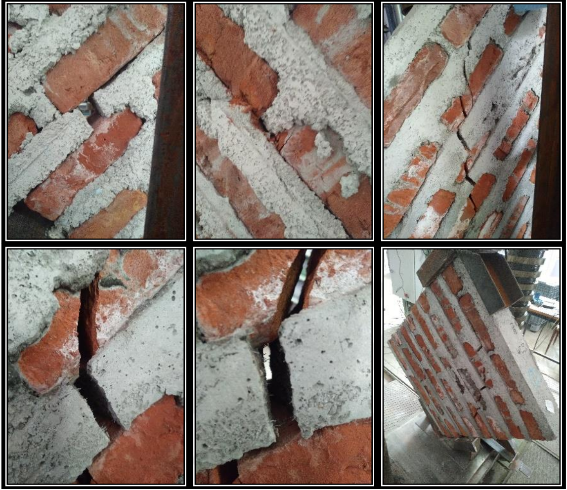
Şekil E1.33. D3L3O3 tip duvarlara ait hasar fotoğrafları
