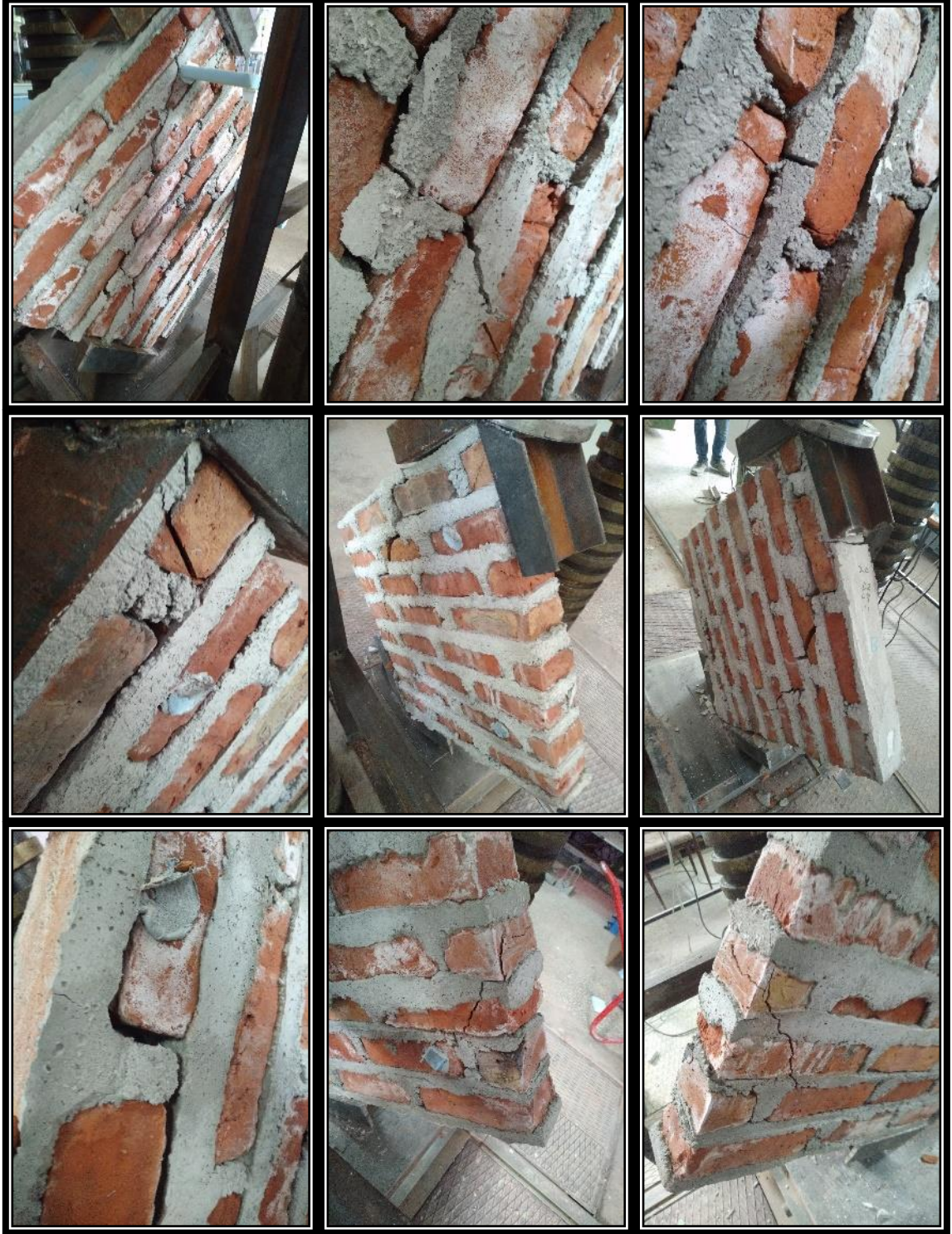
Şekil E1.21. D2L3O3 tip duvarlara ait hasar fotoğrafları
