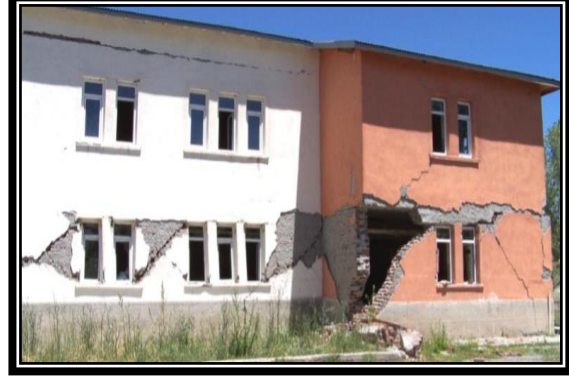
Erzurum depreminde (2004) hasar gören Aşkale ilçesi lise okul binası [38]
