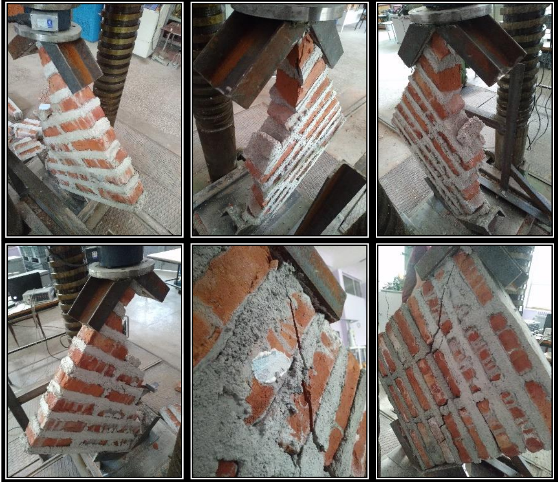
Şekil E1.28. D3L2O1 tip duvarlara ait hasar fotoğrafları
