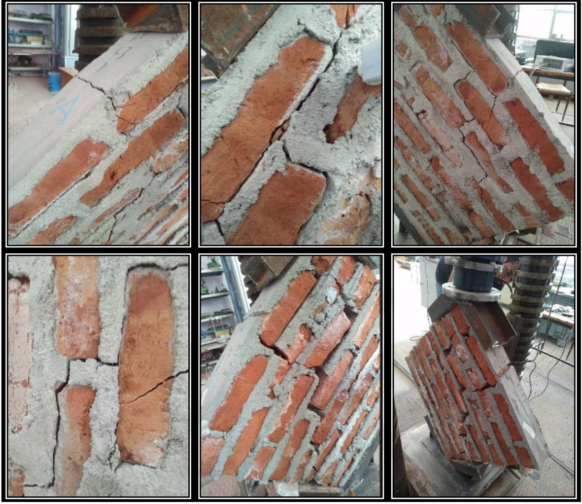
Şekil E1.8. D1L3O2 tip duvarlara ait hasar fotoğrafları
