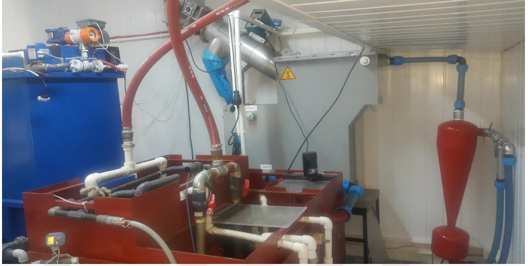
Şekil 3.5.a. Sistemin ön arıtım üniteleri (kum tutucu + döner tambur elek)
