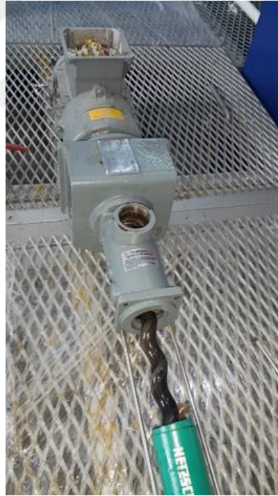
Şekil 5.5. Vakum pompasının arızalanması
