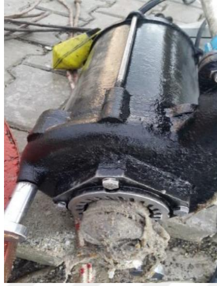
Şekil 5.4. Atıksu alma dalgıç pompasının arızalanması
