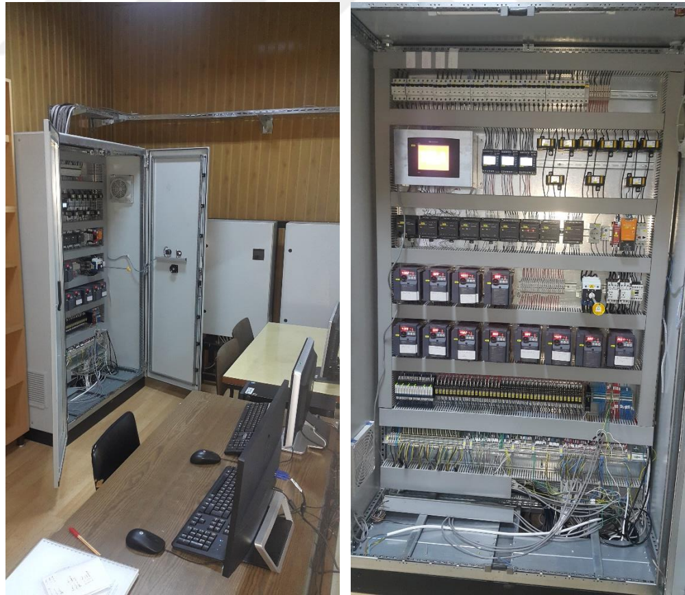
Şekil 3.8. Sistem kontrol odası ve PLC panonun fotoğrafı
